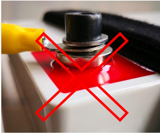
Abbildung 3. FEHLER! Lose Verbindung durch Verwendung einer zu langen Schraube
