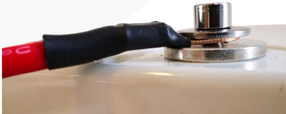
Abbildung 4. FEHLER! Lose Verbindung durch Verwendung einer zu langen Schraube
